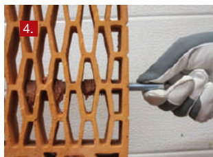
4. Вращательным движением установить металлическую анкерную шпильку в сетчатую гильзу на требуемую глубину.
